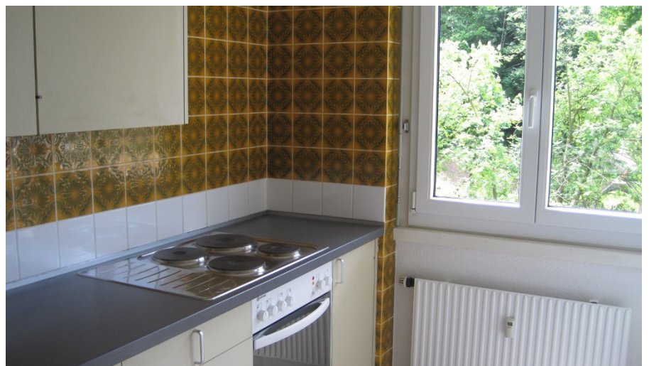
Prima del risanamento, l'equipaggiamento non era più attuale.
